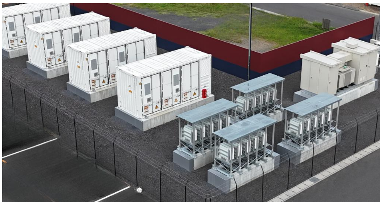
足利市借宿蓄電所
