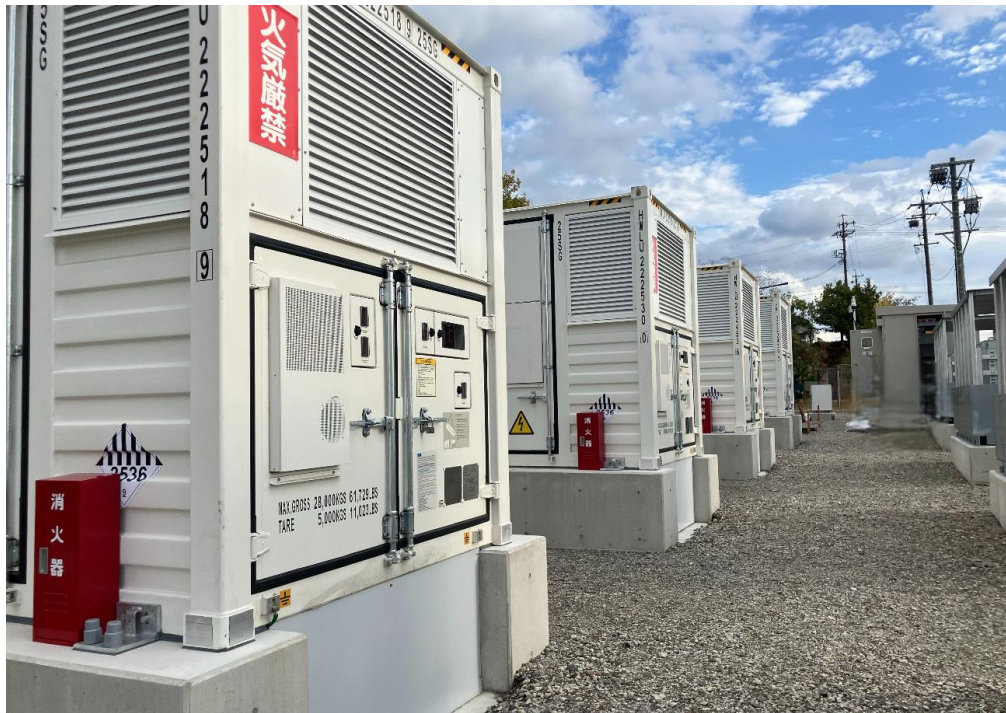
名張市八幡蓄電所
